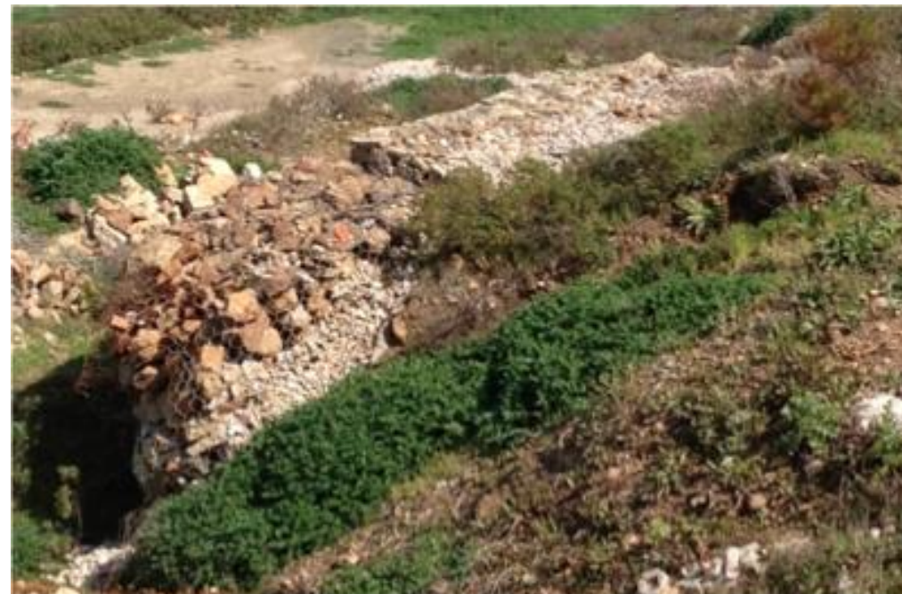
Mur gabion emporté par le glissement
