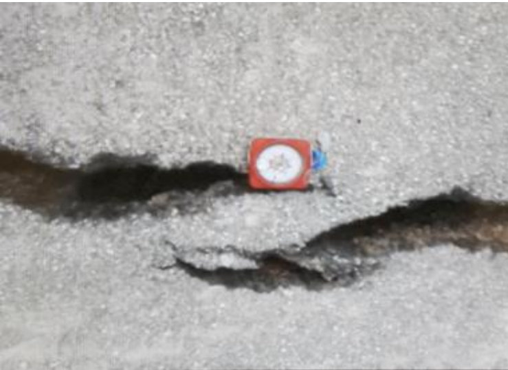
Fissures de direction E-W et d'ouverture N-S.
