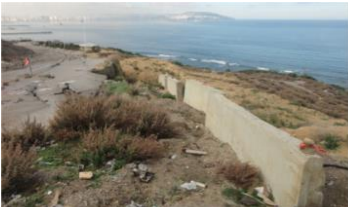
Mur de soutènement déplacé
