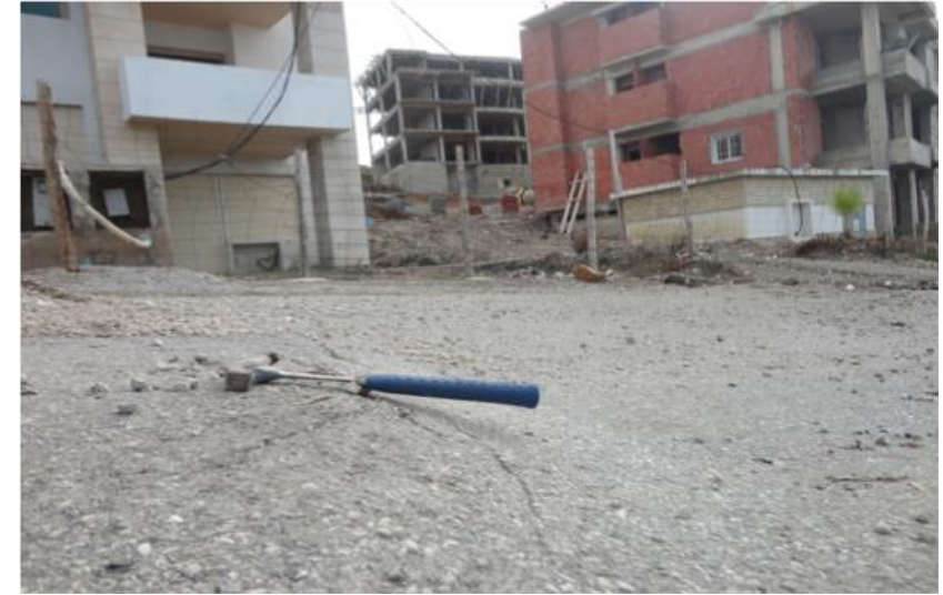
Affaissement de la chaussée
